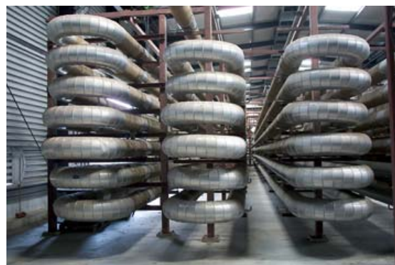
Bild 3: Rohrsystem zur Durchführung der Hydrolyse
